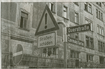
Die Straße Czermaks Garten ist zur Hälfte durch ein Sicherungsgerüst blockiert, das Passanten vor herabfallenden Fassadenteilen schützt. Fotos: Wolfgang Zeyen
